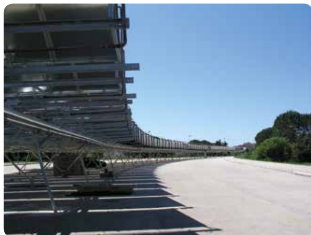
• AUTO KAMP ZATON KRAJ ZADRA – 1036 TEHNOMONT SOLARNIH KOLEKTORA, NAJVEĆE POLJE U HRVATSKOJ
